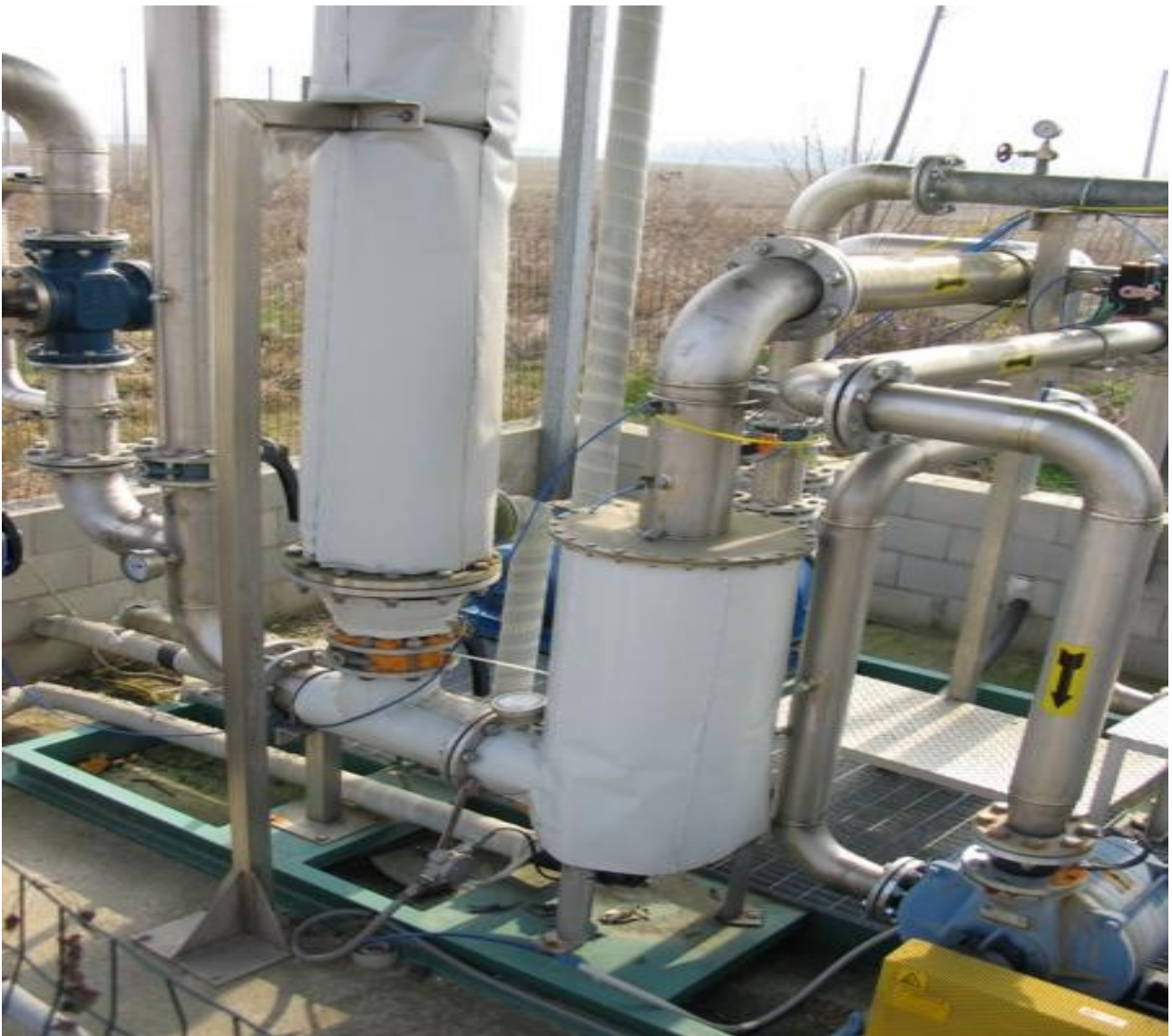
Gli innumerevoli tubi dell'impianto di co-generazione dove passa il biogas
